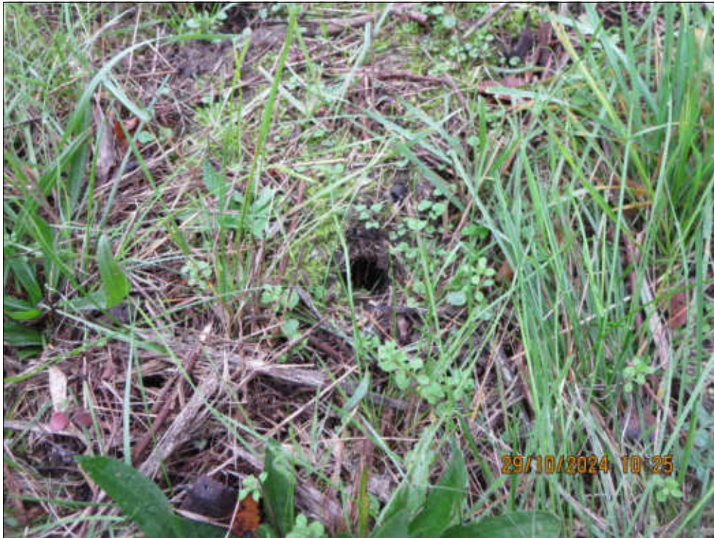
Abb. 55 Loch im Böschungsbereich
