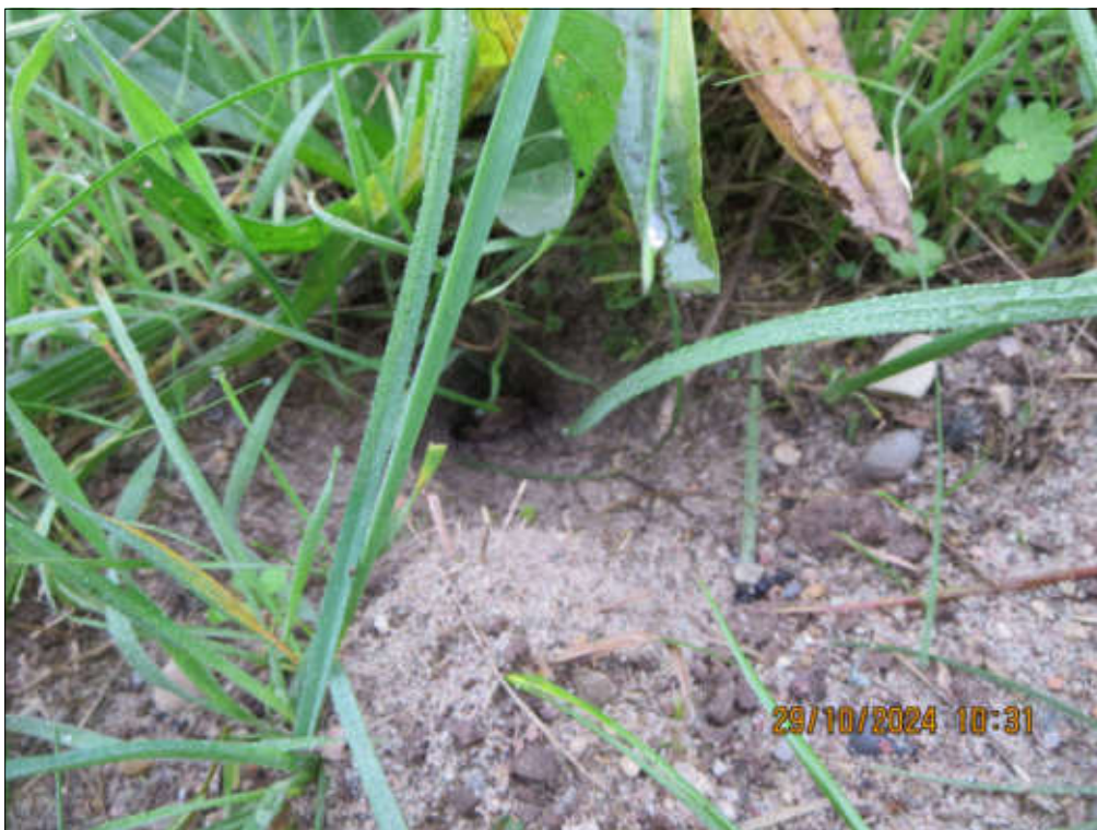
Abb. 60 Loch im Böschungsbereich
